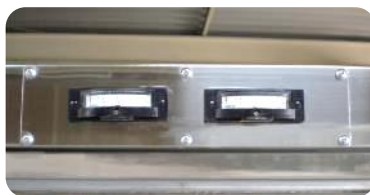
ラック内圧力監視
