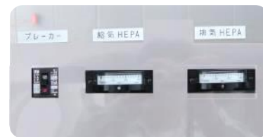
フィルタ詰り監視
