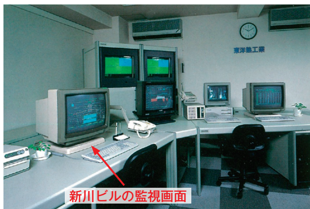
写真10 旧本社ビル1Fの群管理センター
