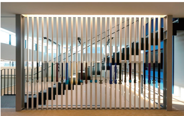
写真9 配管ルーバー
