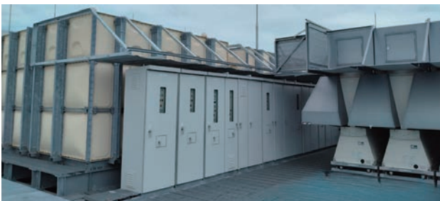
写真2 熱波対策後（チラー、タンク）
