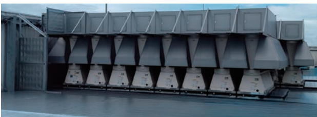
写真1 熱波対策後（チラー、通路部）
