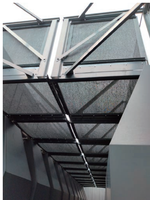
写真3 熱波対策後（チラー間）
